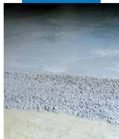
Massetto di sottofondo additivato con Idrosilex
